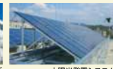
太陽光発電システム
