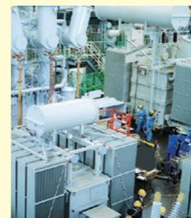
変圧器工場での出荷前試験の様子
