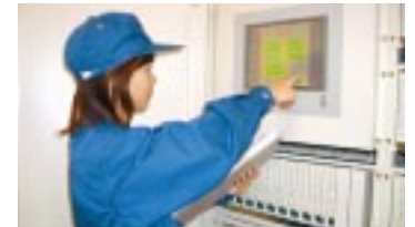
制御装置を点検
