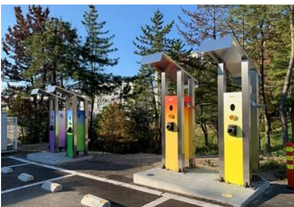
急速充電システム
