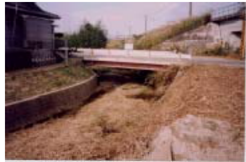
写真 6 未確認地点下流部（空間）
